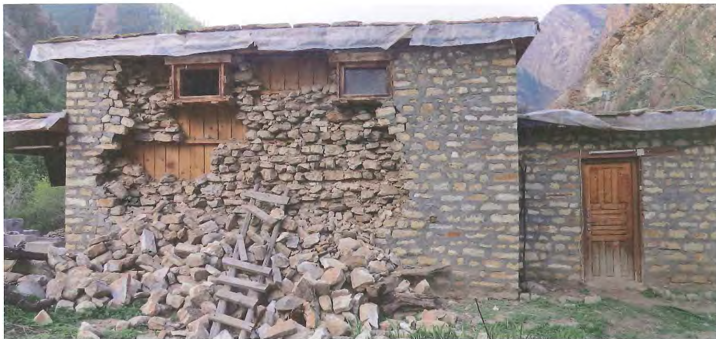
Beschädigte Amchiklinik: Die Aussenwand der Amchiklinik für traditionelle tibetische Medizin, direkt neben unserem Health Post in Chunubar gelegen, wurde durch das Erdbeben stark beschädigt (Fotos: Semduk Lama)
